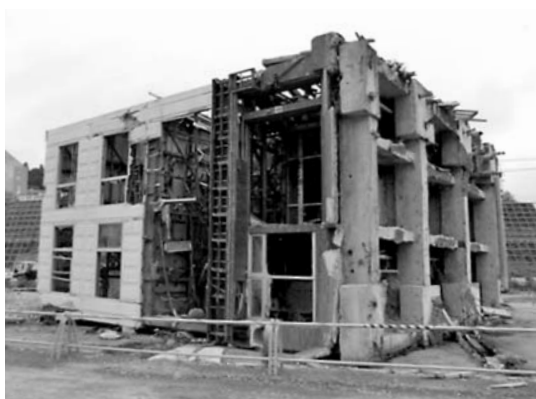
女川町で倒壊したビル
